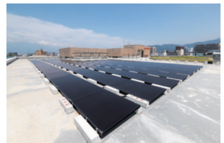
本部棟の太陽光発電システム
